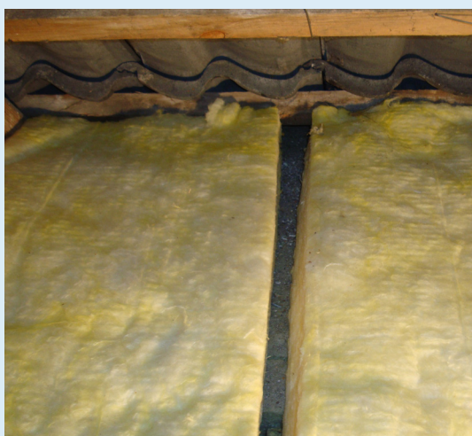
Loftisolering med sprække.
