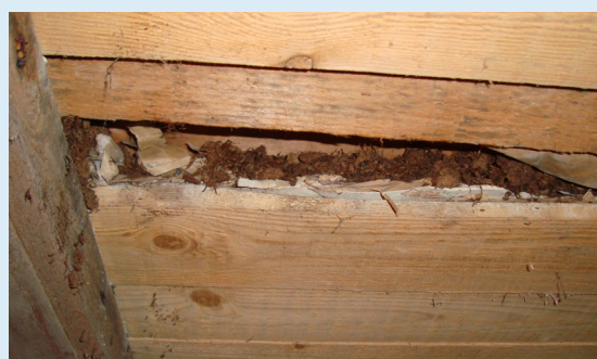
Gulv over krybekælder isoleret med 30 mm tørv.
