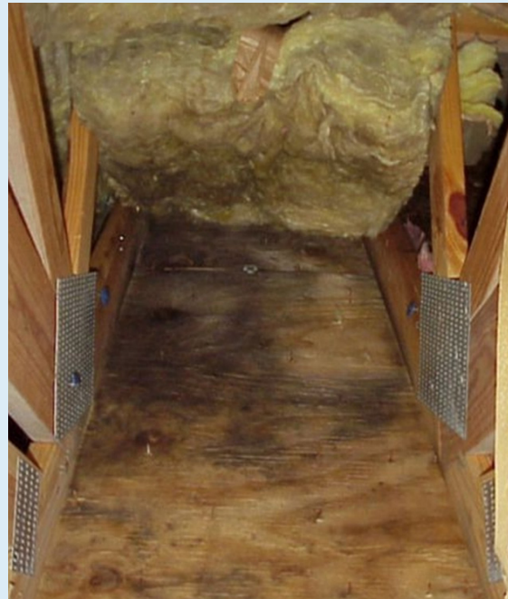
Fugtskade med angreb af skimmelsvamp.
