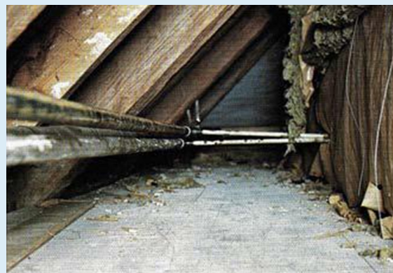
Uisolerede centralvarmerør i skunkrum.
