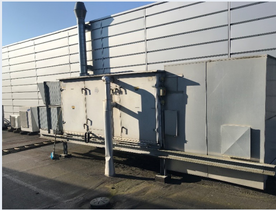
Figur 31. Typisk ventilationsanlæg for bygningstypen.
