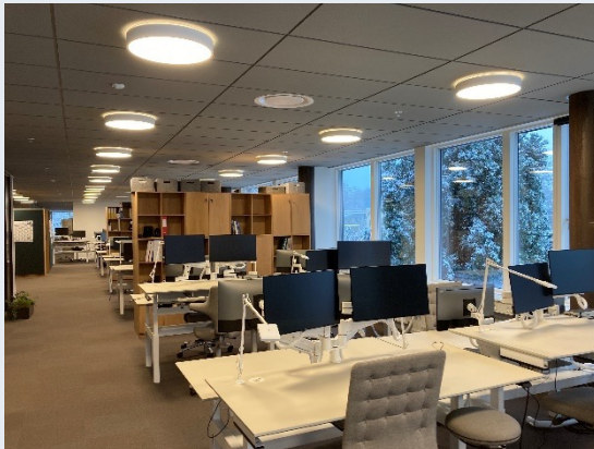
Figur 40. Typisk belysningsanlæg for bygningstypen.
