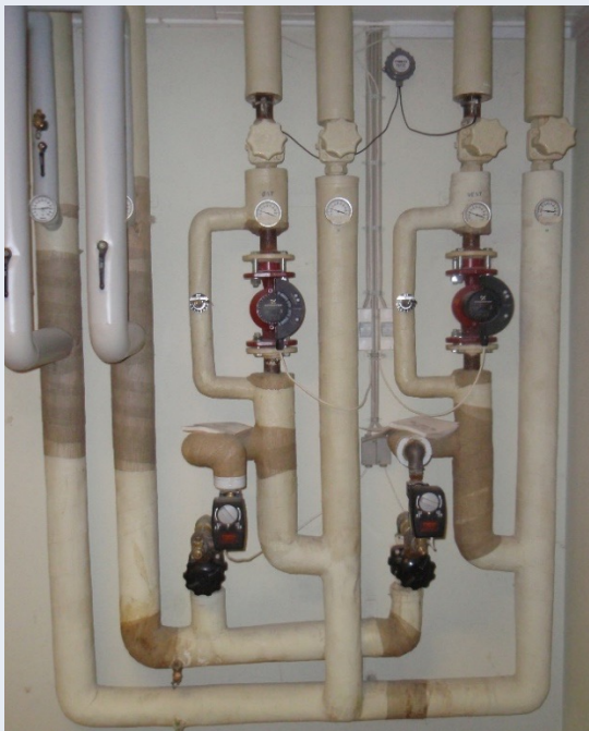
Figur 18. Typisk varmeanlæg for bygningstypen.
