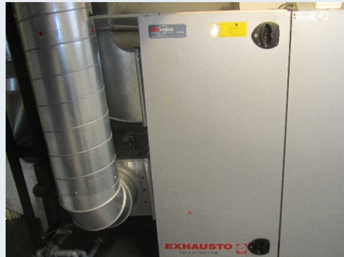
Figur 24. Typisk ventilationsanlæg for bygningstypen.
