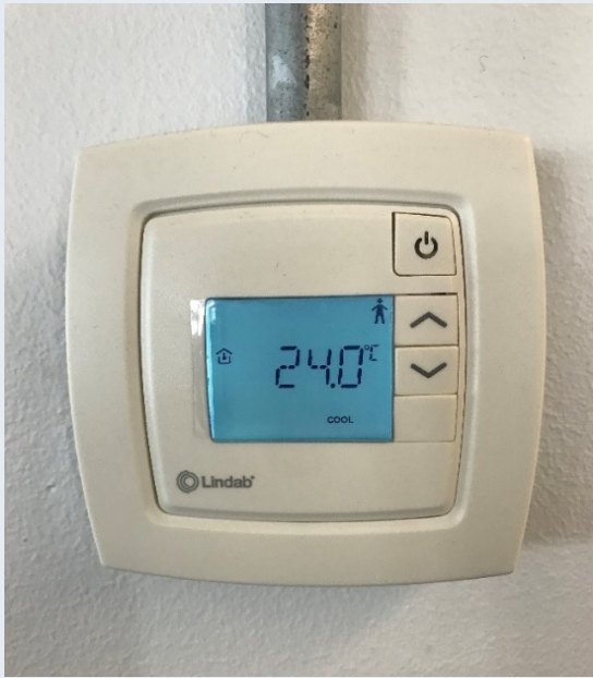
Figur 37. Typisk lokalt betjeningspanel til indstilling af ventilationsanlæg for bygningstypen.
