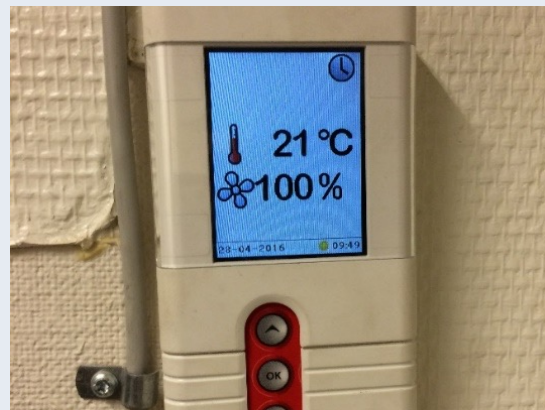
Figur 15. Typisk lokalt betjeningspanel til indstilling af ventilationsanlæg for bygningstypen.
