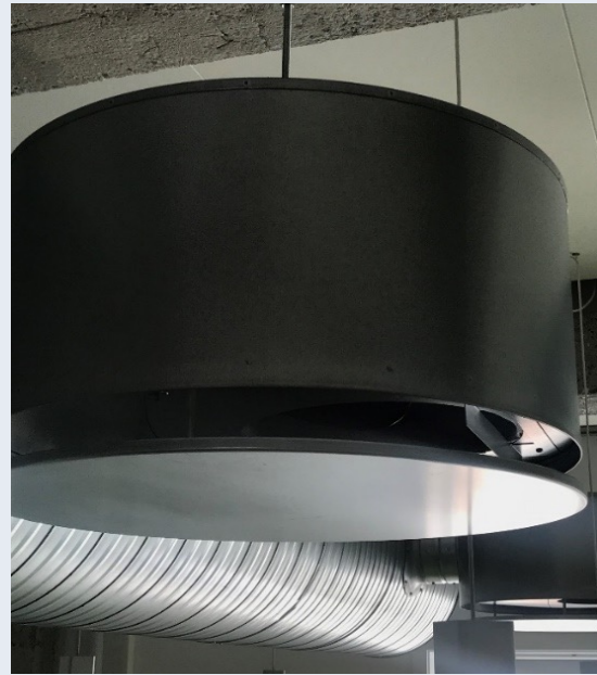
Figur 38. Typisk ventilationsanlæg for bygningstypen.
