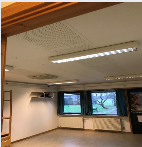
Figur 16. Typisk belysningsanlæg for bygningstypen.
