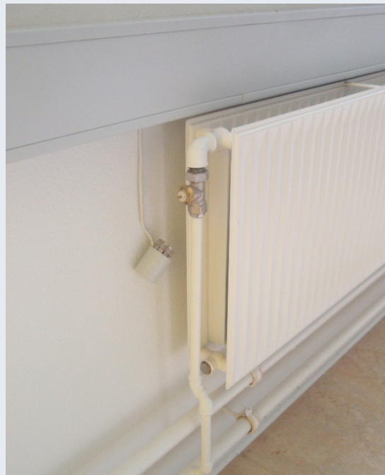
Figur 19. Typisk radiator og termostatventil for bygningstypen.
