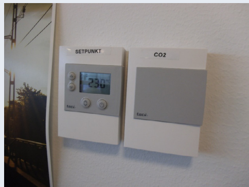
Figur 33. Typisk lokalt betjeningspanel til indstilling af ventilationsanlæg for bygningstypen.
