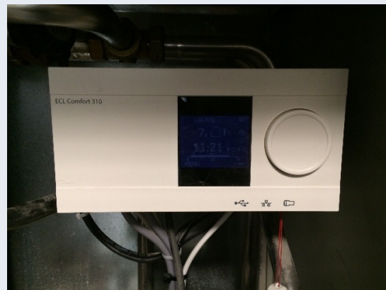
Figur 7. Typisk udetemperaturkompenseringsanlæg for bygningstypen.
