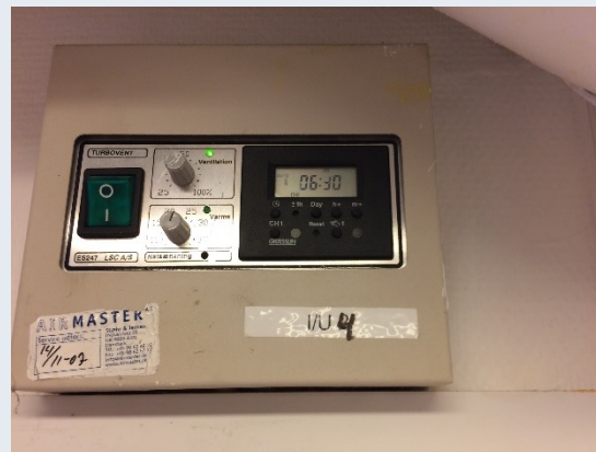
Figur 4. Typisk lokalt betjeningspanel til indstilling af ventilationsanlæg for bygningstypen.
