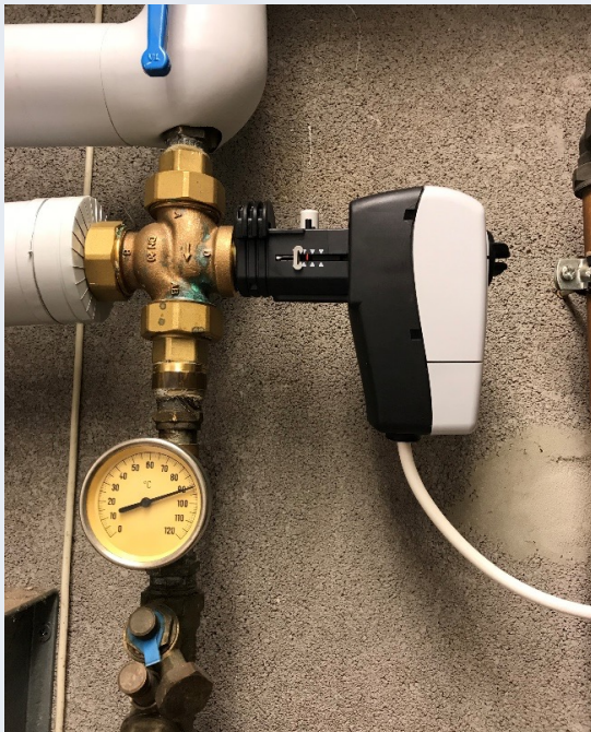
Figur 12. Typisk varmeanlæg for bygningstypen.
