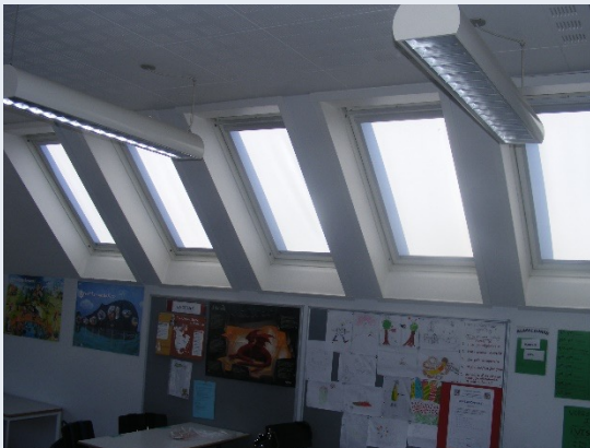
Figur 25. Typisk belysningsanlæg for bygningstypen.
