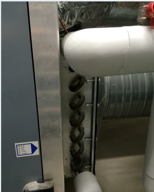
Figur 8. Typisk ventilationsanlæg for bygningstypen.
