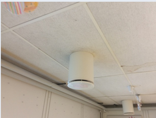
Figur 14. Typisk ventilationsanlæg for bygningstypen.
