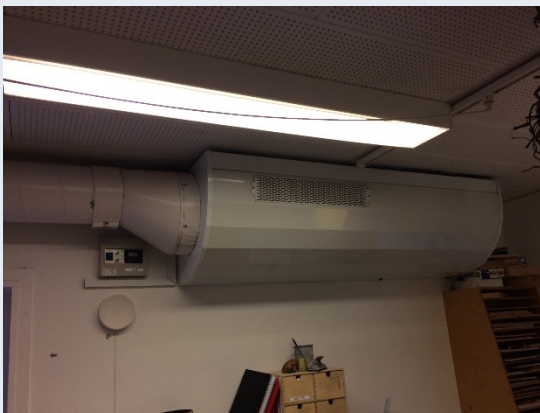
Figur 3. Typisk ventilationsanlæg for bygningstypen.
