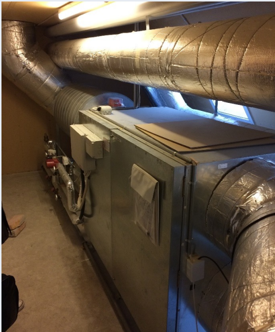
Figur 20. Typisk ventilationsanlæg for bygningstypen.
