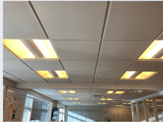
Figur 32. Typisk belysningsanlæg for bygningstypen.
