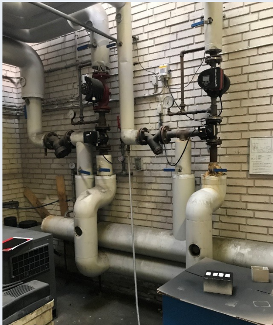
Figur 29. Typisk varmeanlæg for bygningstypen.
