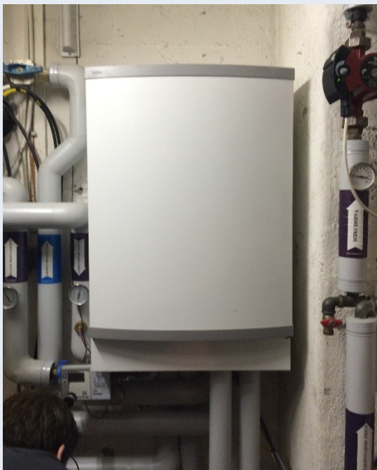
Figur 6. Typisk varmeanlæg for bygningstypen.
