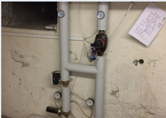
Figur 1. Typisk varmeanlæg for bygningstypen.
