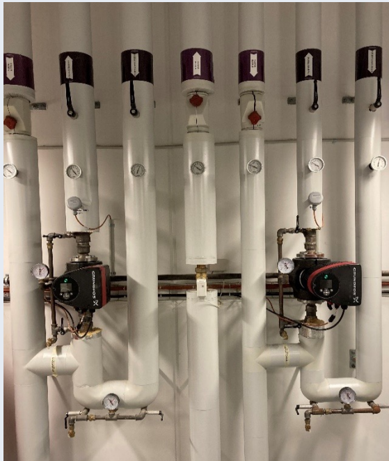
Figur 22. Typisk varmeanlæg for bygningstypen.
