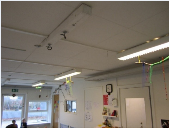
Figur 10. Typisk ældre belysningsanlæg for bygningstypen.
