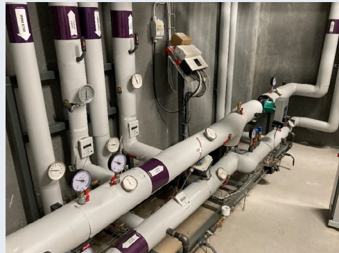
Figur 27. Typisk varmeanlæg for bygningstypen.
